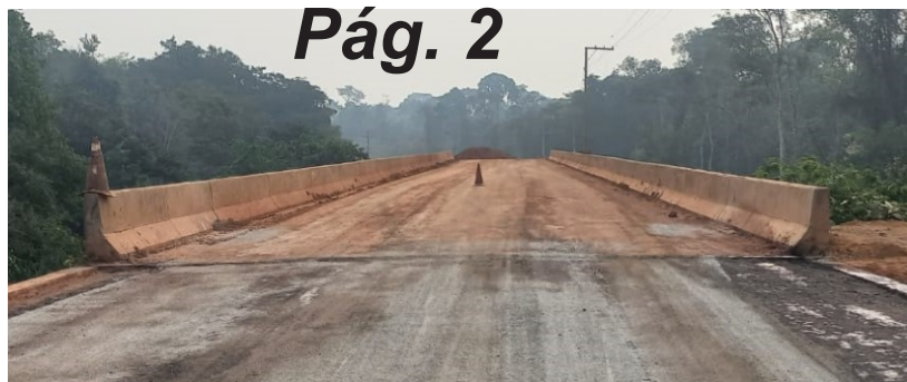
Impermeabilização (primeira camada após terraplanagem), já está na ponte do Rio Bruno - há 12 km de Apicás. Foto Gustavo Caetano dia 25-09-24
