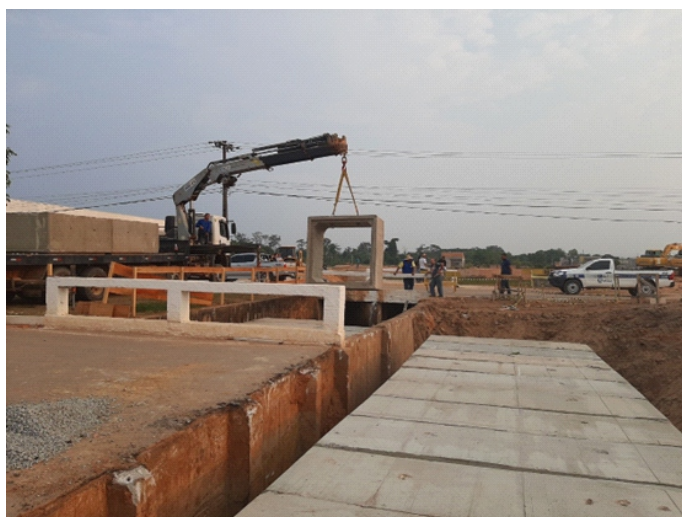
O vão entre as pontes existentes da Avenida, também será colocado as peças. Objetivo: segurança. Obra da ponte (aduelas), empresa: Antônio Ramos da Silva e Cia Ltda. Valor do Contrato R$278.978,12.
