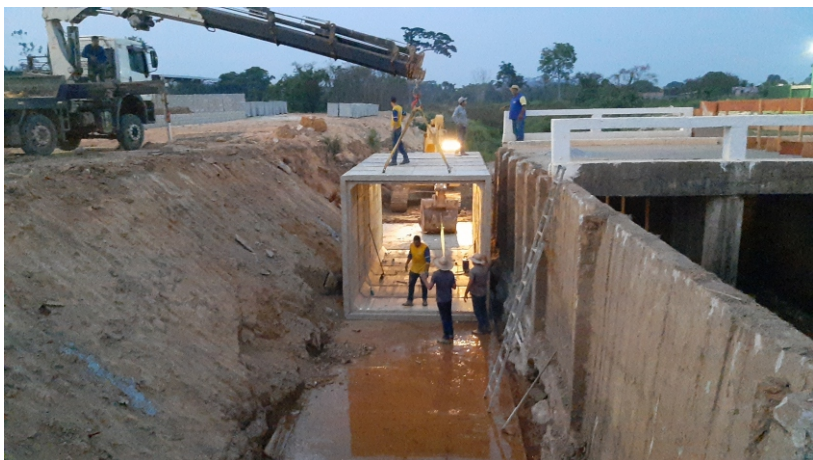
Foto 12-09-22. Início da colocação das peças para formar a ponte (duplicação da ponte existente).
